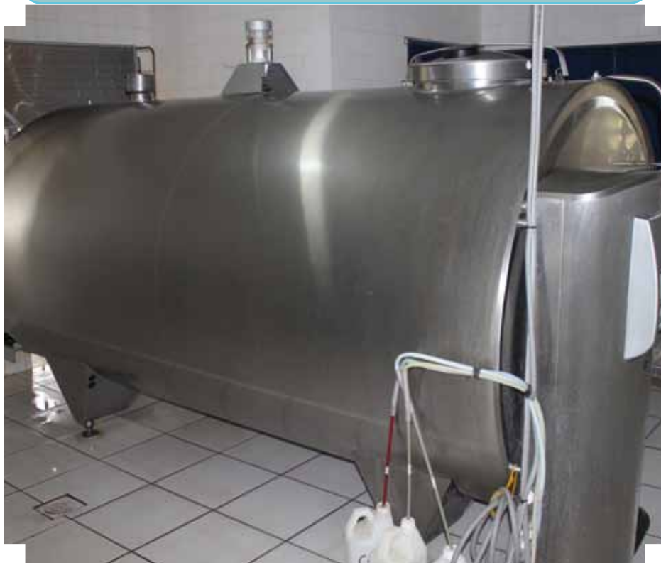
Tanque de refrigeração
